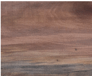
POURISSEMENT : La destruction de la substance du bois par des champignons. La décoloration de l'aubier est une première preuve du pourrissement.
